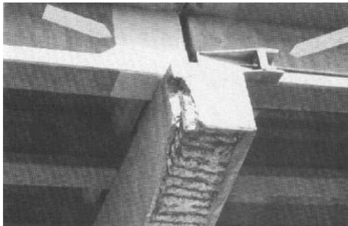
Fig. 2.98 - Délamination dues à la corrosion dans une poutre en béton armé. Les problèmes de corrosion sont, en partie, causés par un joint mal entretenu. [tiré de Novokshchenov, V. 1991 Prestressed concrete bridges in adverse environment, Concrete International, Vol. 13, No, 5 May. P. 43-48].
