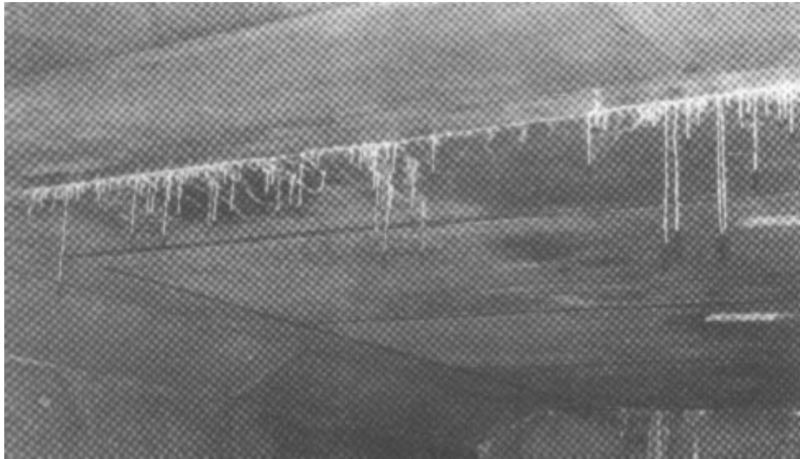
Fig 1.7 - Pénétration des chlorures dans une poutre caisson [tiré de Pritchard B. 1992 Bridge design for economy and durability , Thomas Telford Services London, 172 p.].
