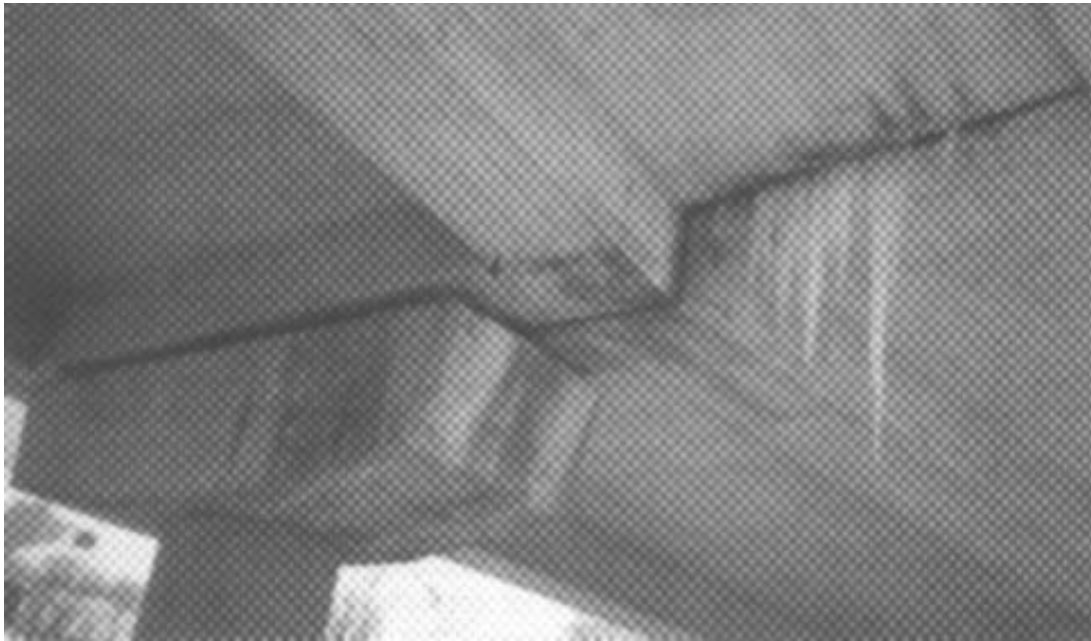
Fig 1.17 - Défaut d'entretien d'un joint [tiré de Pritchard B. 1992 Bridge design for economy and durability , Thomas Telford Services London, 172 p.].
